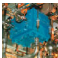
Подвешенный Компаблок в системе конденсации
